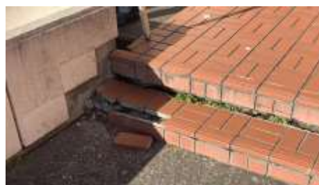
校舎周りの階段部分 損傷
