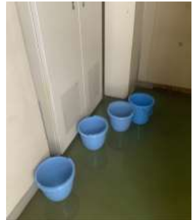
体育館 雨漏り 電気設備が影響を受け、 フロア照明が使えません
