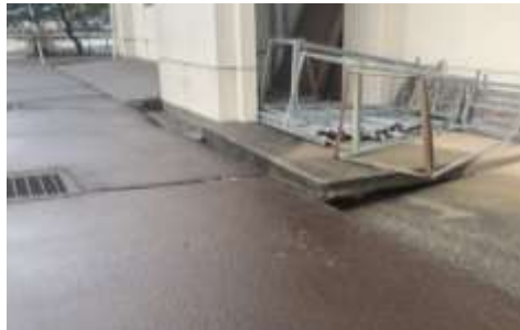
体育館脇コンクリート部分 隆起・陥没
